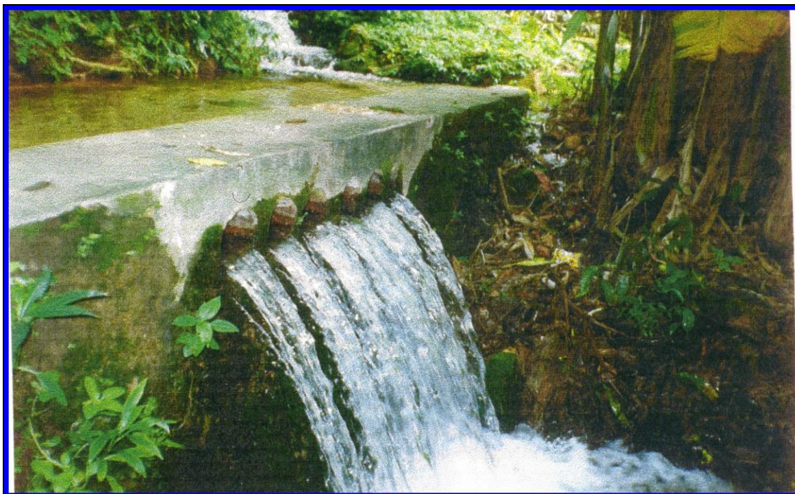
Figura 4.1 – Instrumento de medida de vazão utilizado no município de Crato a partir da partilha das águas da Fonte Batateira.
