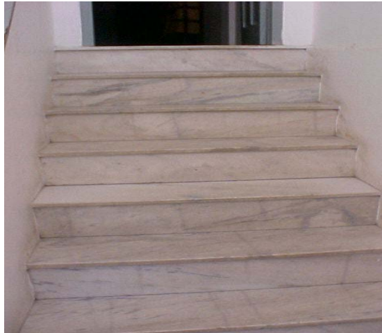
Fotografia 5 Demonstrativo de escadas sem corrimão
