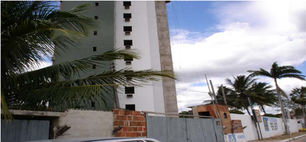
Fotografia 2 Construção sem proteção por tapume vizinha ao hospital
