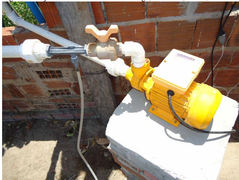
Figura 7 – Injetor Venturi e bomba centrífuga, Fortaleza, Ceará, 2010.
