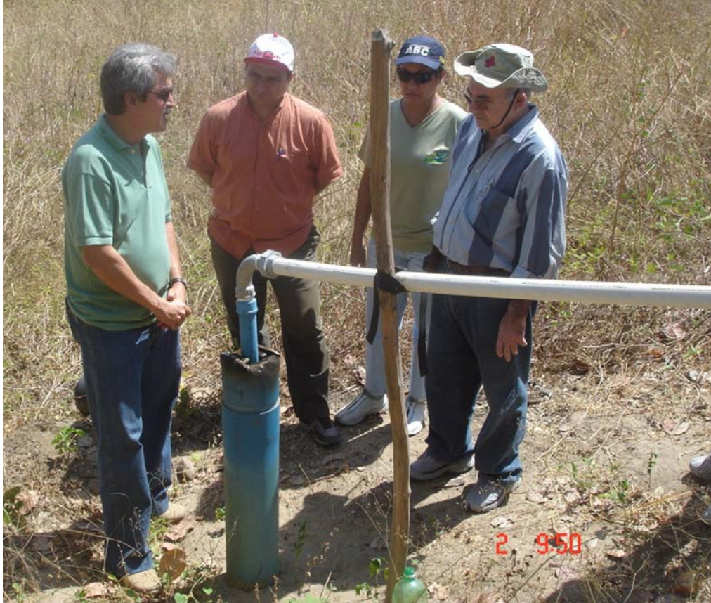
FIGURA 3 – Poço manual tubular construído às margens do Rio Curu, Ceará.
