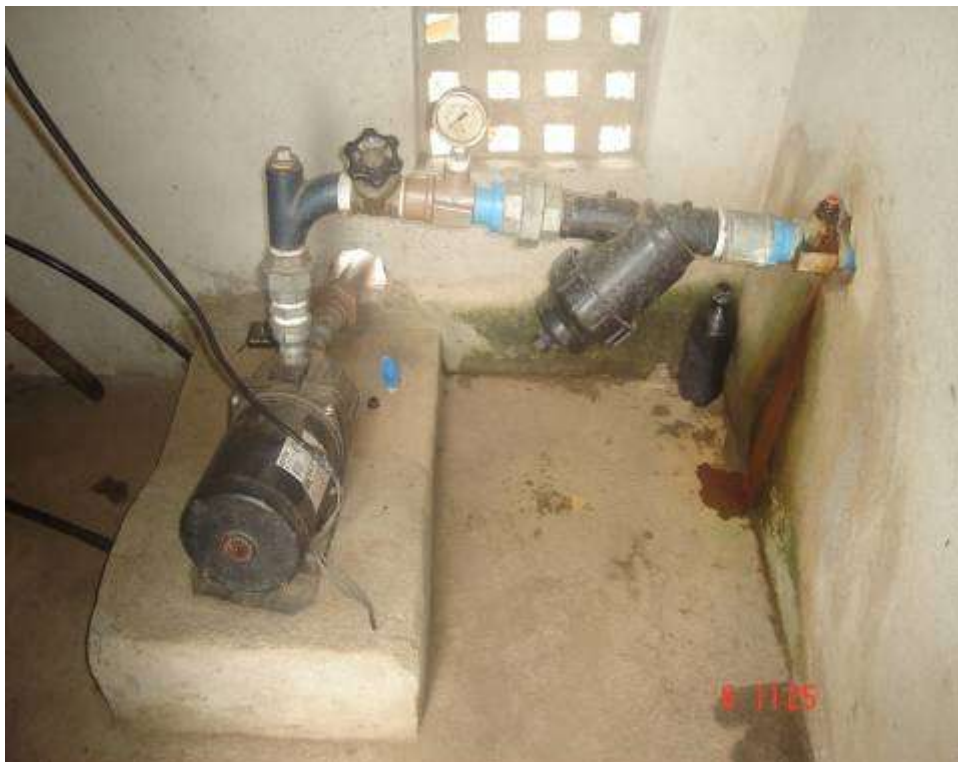
Figura 06 – Sistema de bombeamento da água de poço.
