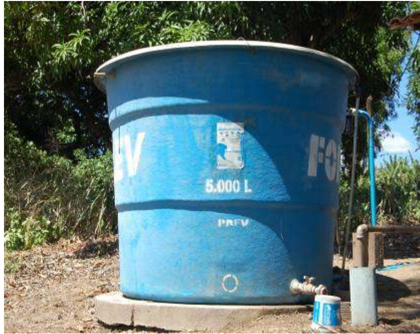
Figura 10 – Caixa d'água para armazenamento de água do canal.
