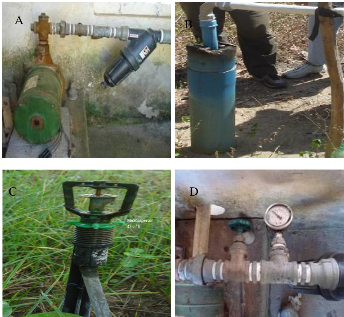
Figura 4 - (A) conjunto motor bomba, (B) poço tubular, (C) microaspersor, (D) manômetro e registro de gaveta
