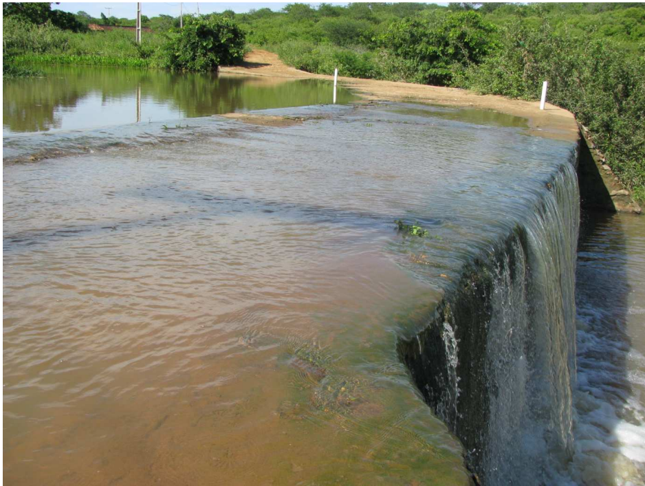
Figura 10 - Transbordamento do lago formado pela passagem molhada na seção da Aroeira
