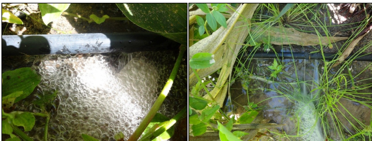
Figura 49 – Falhas no sistema hidráulico
