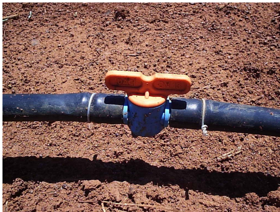
Figura 10: Detalhe do registro no início da linha lateral
