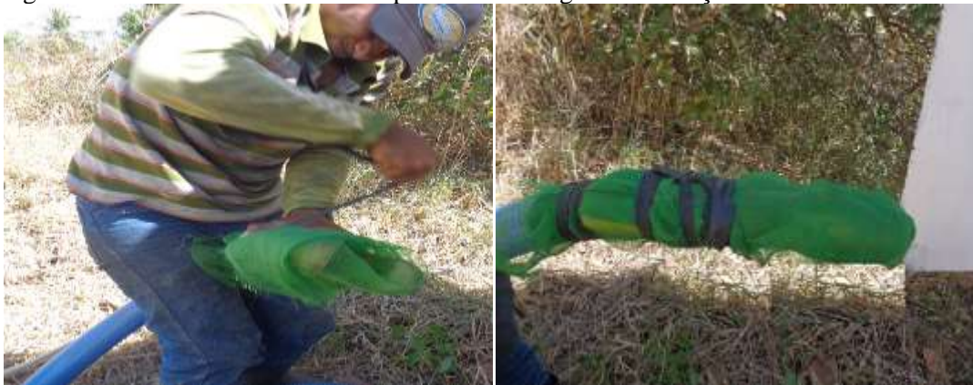
Figura 8 - Rede contra entrada de impurezas na mangueira de sucção.
