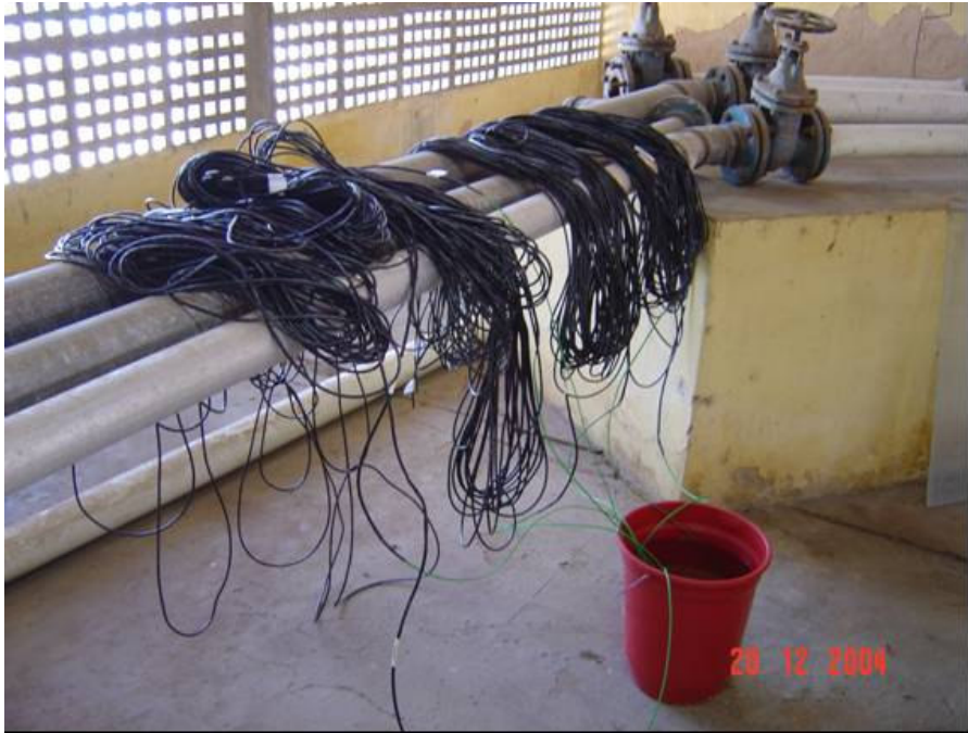
Figura 9. Visão geral dos cabos para a ligação dos sensores de umidade.
