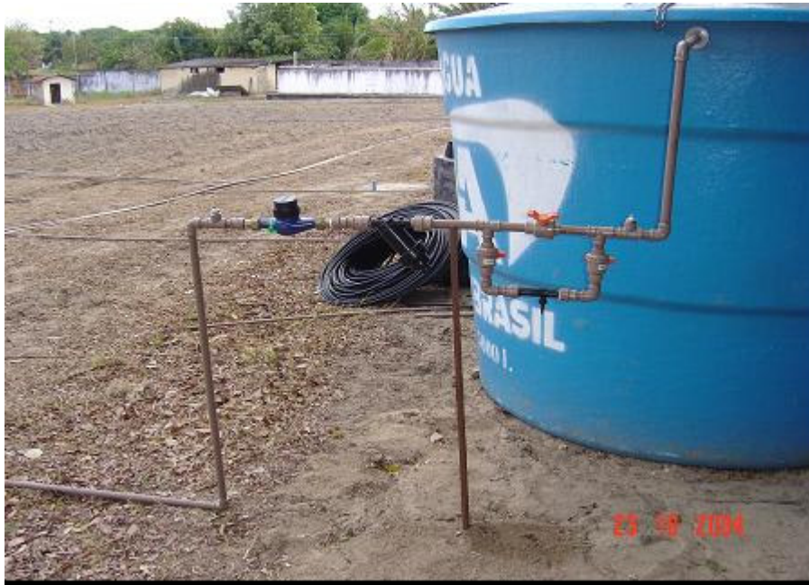
Figura 17. Cabeçal de controle do sistema.
