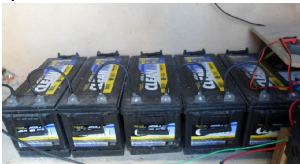
Figura 14 - Banco de baterias do sistema eólico-elétrico
