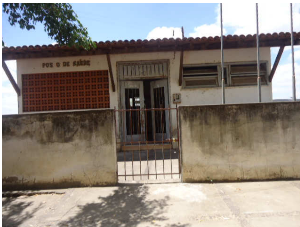
Figura 8 – Posto de Saúde em estado de degradação pela falta de manutenção pelos gestores públicos
