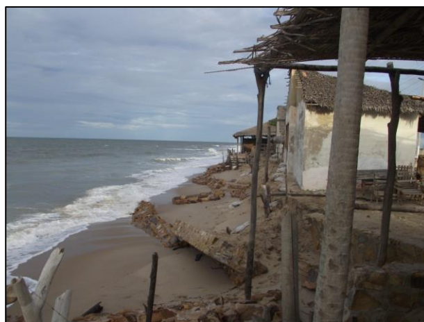
Figura 87: Praia da Pedra do Sal, a montante do promontório (Célula 5a). Perfil inclinado e ataque das ondas em praia de alta energia erodindo a zona de berma e destruindo benfeitorias.
