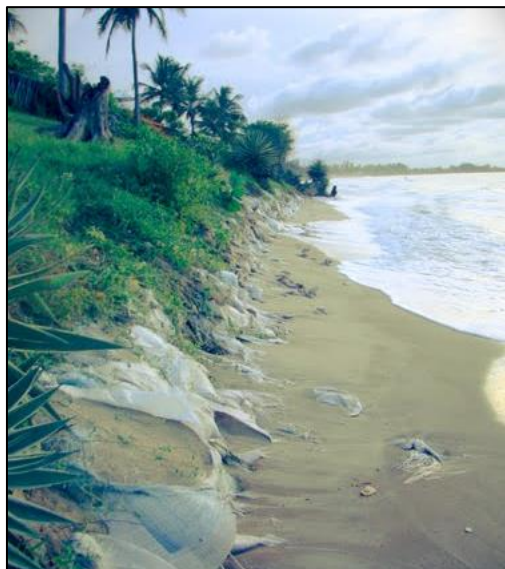
Figura 86: Praia do Coqueiro (Célula 3). Perfil inclinado e ataque das ondas erodindo a zona de berma e atingindo residências.
