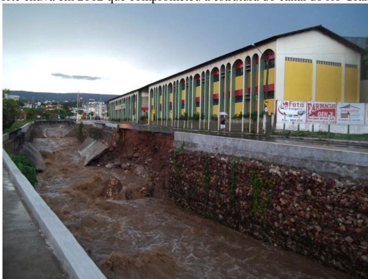
Figura 81 - Forte chuva em 2012 que comprometeu a estrutura do canal do rio Granjeiro no Crato
