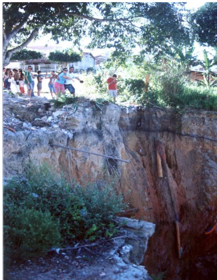
Figura 10 – Cabeceira da voçoroca no bairro Urbis I (jul/2006).
