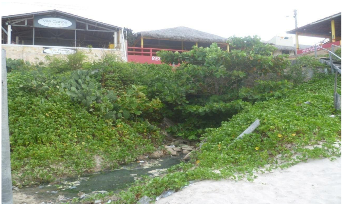
Figura 38 – Esgoto a céu aberto na praia de Canoa Quebrada (Fonte: PEDROSA, 2014).
