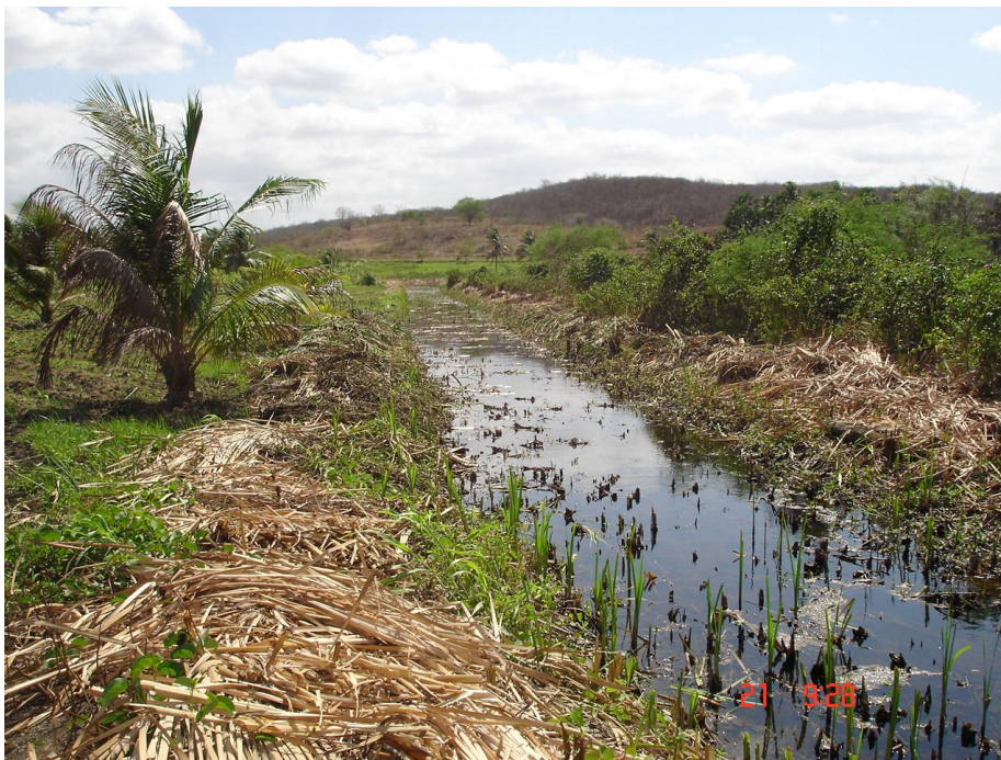
Figura 8 - Coletor após a limpeza (fonte de descarga).
