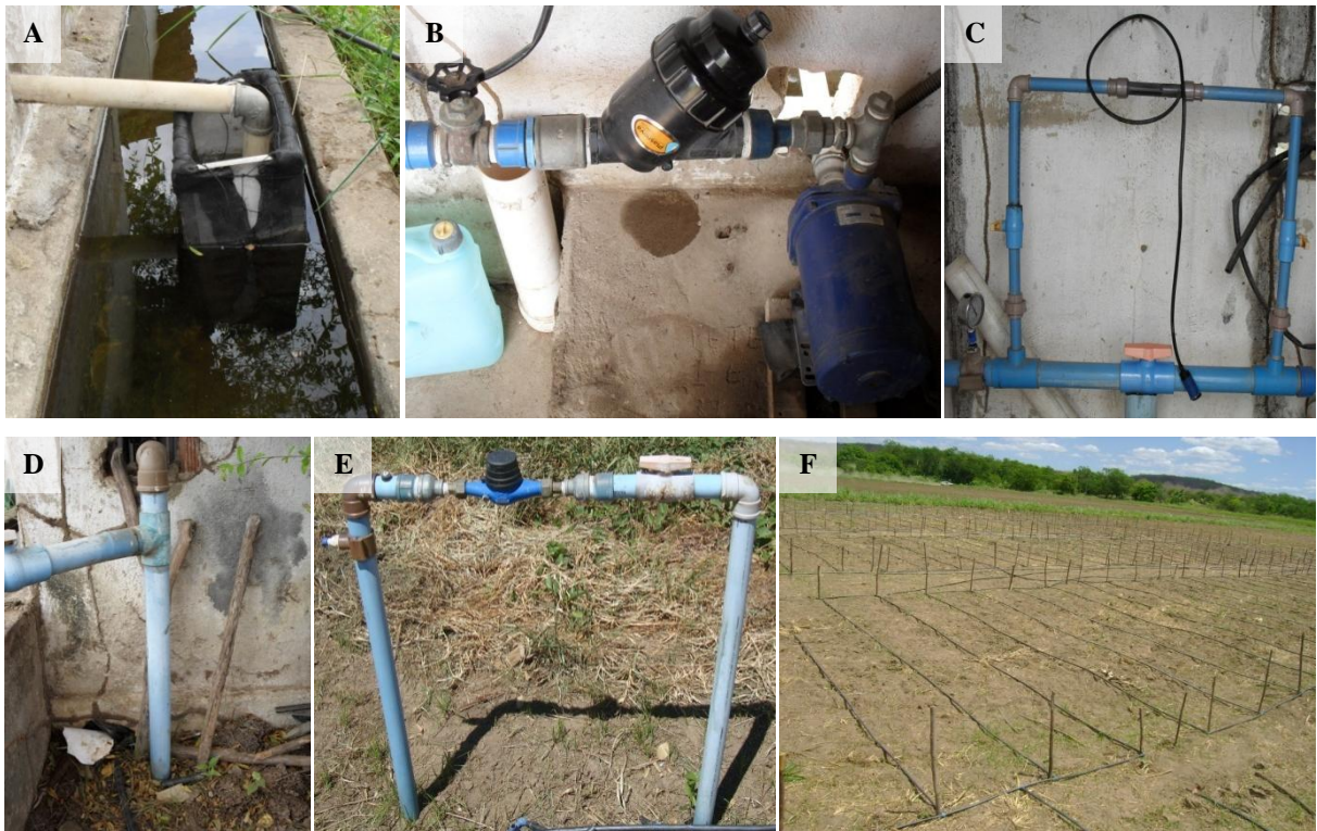
Figura 9 – Componentes do sistema de irrigação. Adução (A), sistema motobomaba e filtro de disco (B), injetor de fertilizantes (C), linha principal (D), cavalete (E), linhas laterais (F). Pentecoste – CE, 2010.
