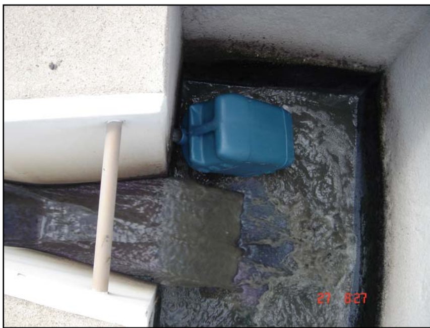
FIGURA 13 – Vista superior da coleta de esgoto bruto na ETE - Aquiraz.
