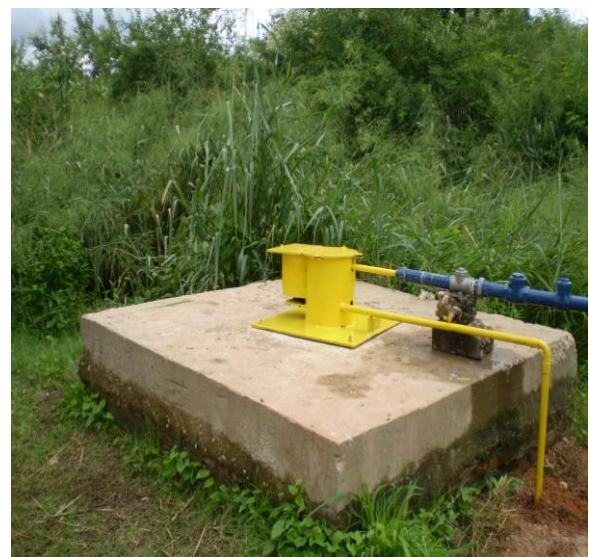
Figura 18 - Elevatória em operação.
