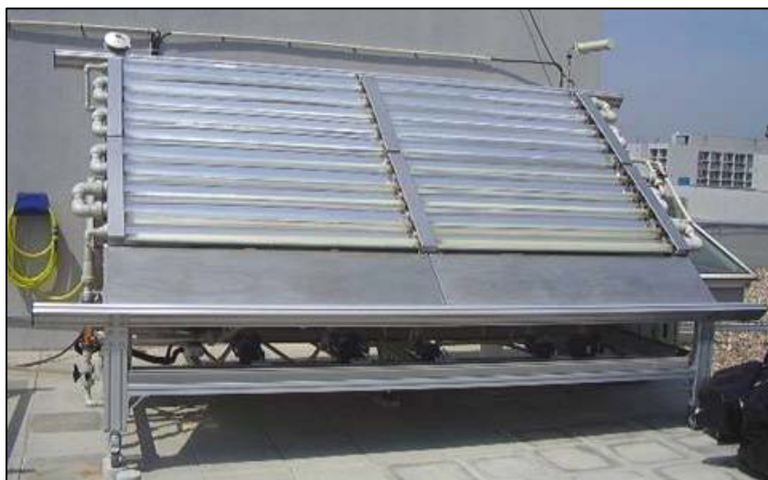
Figura 3.12: Coletores solares instalados no DEQ – FEUP-Portugal.
