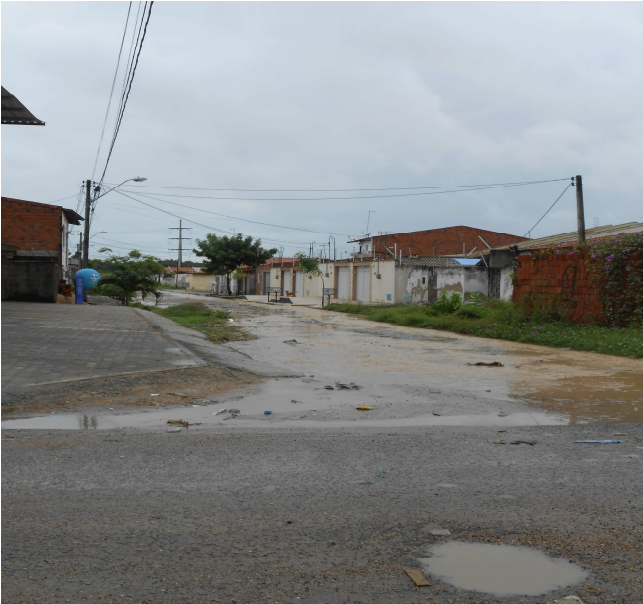
Imagem 1 – Pavimentação e drenagem das ruas insuficiente
