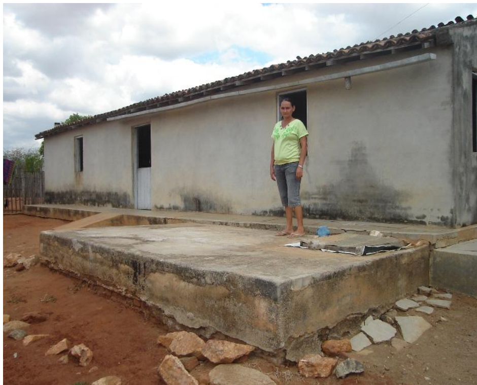
Figura 5.6: Cisterna de alvenaria de 19,17 m 3 destinada ao abastecimento multifamiliar ( Sítio Cipó, Milhã, 2009)
