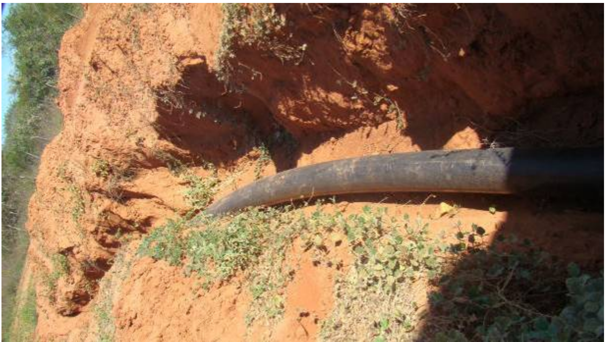
Figura 5.30. Adutora de PEAD no trecho gravit rio a jusante do Reservat rio
