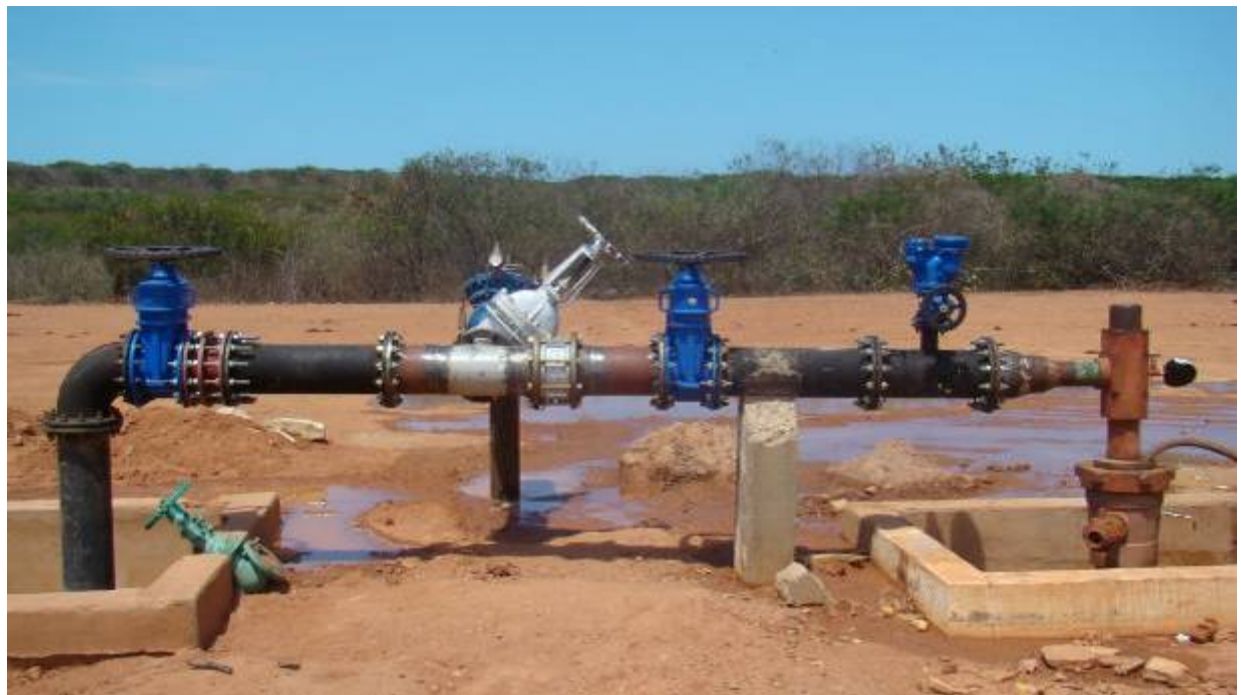
Figura 5.26. Cabeça do Poço e tubulação de ferro fundido no início da adutora
