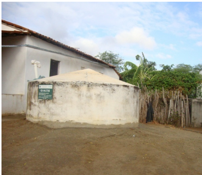
FIGURA 8 – Cisterna de placa na comunidade Nova Vida I. Out/09.
