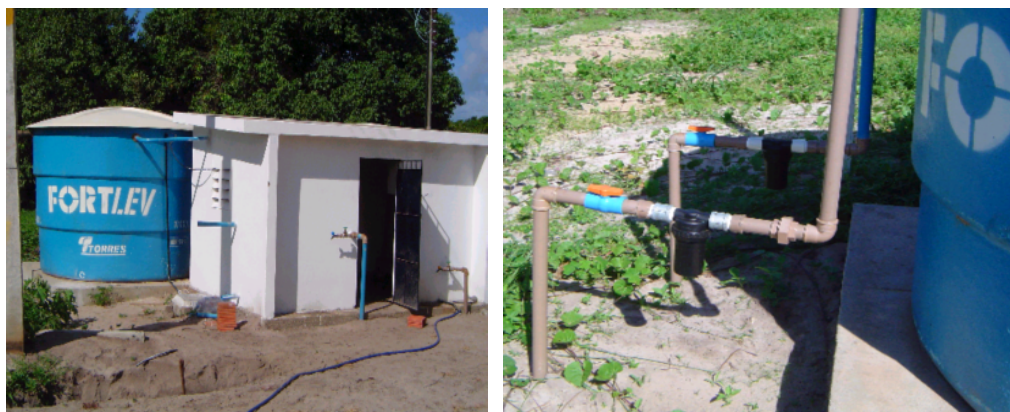
FIGURA 4.4 - Casa de bombas e reservatório (esquerda) e os filtros instalados (direita), Aquiraz, CE, 2005.
