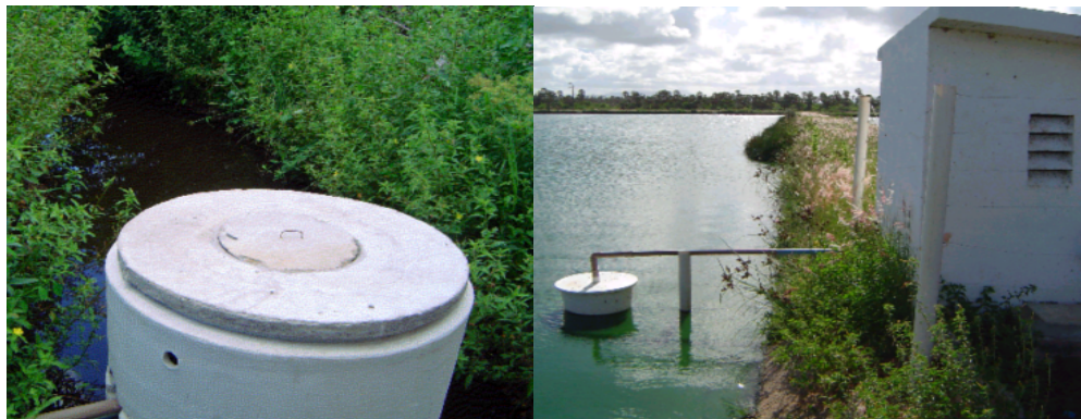
FIGURA 4.3 - Sistema de captação de água (esquerda) e esgoto da ETE (direita), Aquiraz, CE, 2005.
