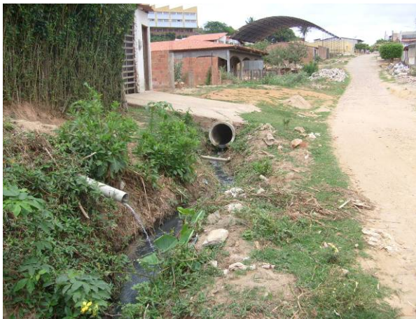
(e) Lançamento de esgoto na drenagem
