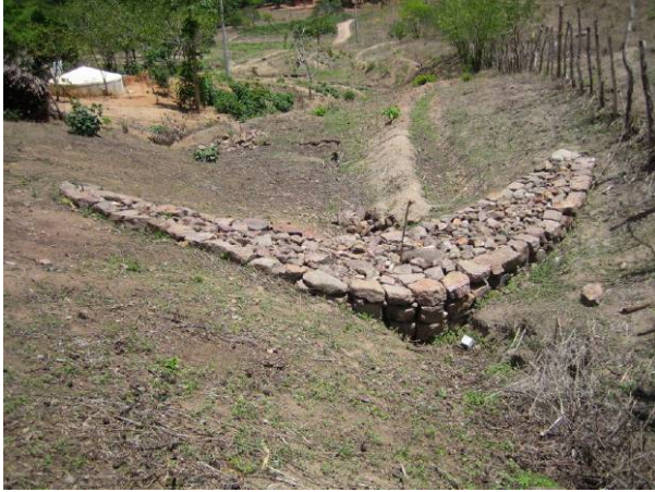
(a) Microbarragem de contenção de sedimentos
