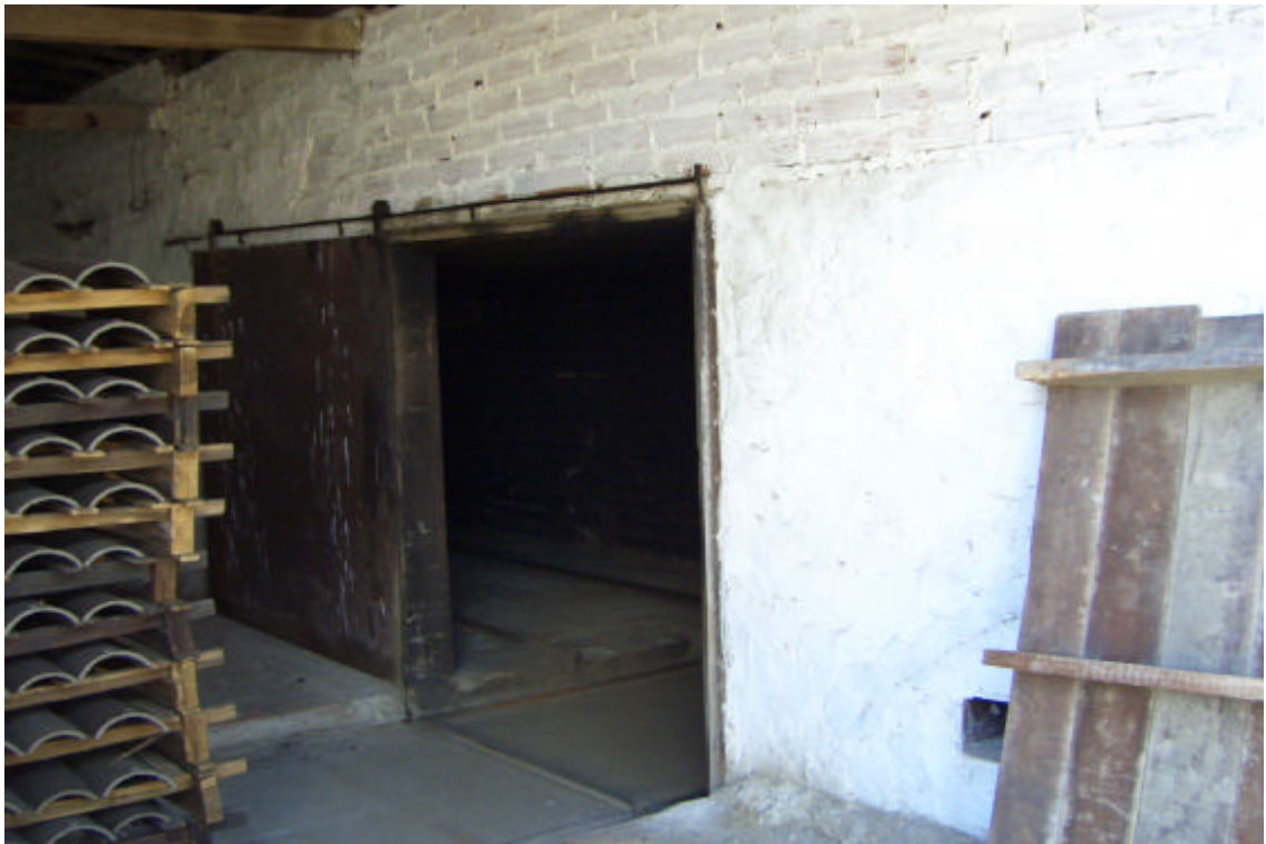
Foto 19. Porta de secador artificial que utiliza o ar quente proveniente da câmara de um forno em fase de resfriamento da carga.
