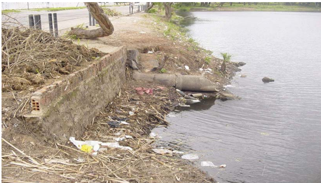
Foto 02: Fonte de poluição por esgotos lançando direto no recurso hídrico do Parque Ecológico da Lagoa da Maraponga.
