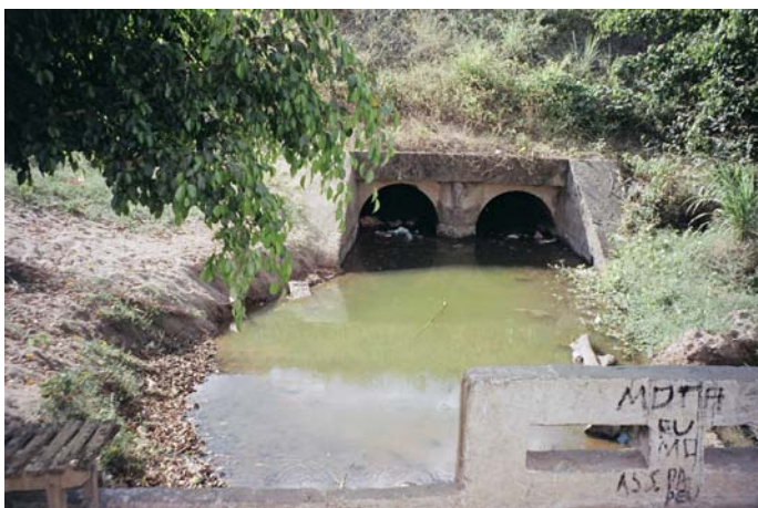
Foto 12: Saída de esgoto localizada na rua principal da Sede do Município em frente às lojas comerciais.
