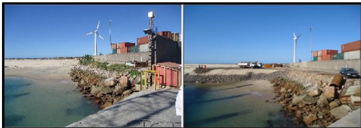
Figura 15 Construção do Terminal de Passageiros. À esquerda imagem datada de 27 de junho de 2012 sem alterações significativas e à direita em 25 de julho de 2012 com redução da faixa de praia. Fonte: autor.
