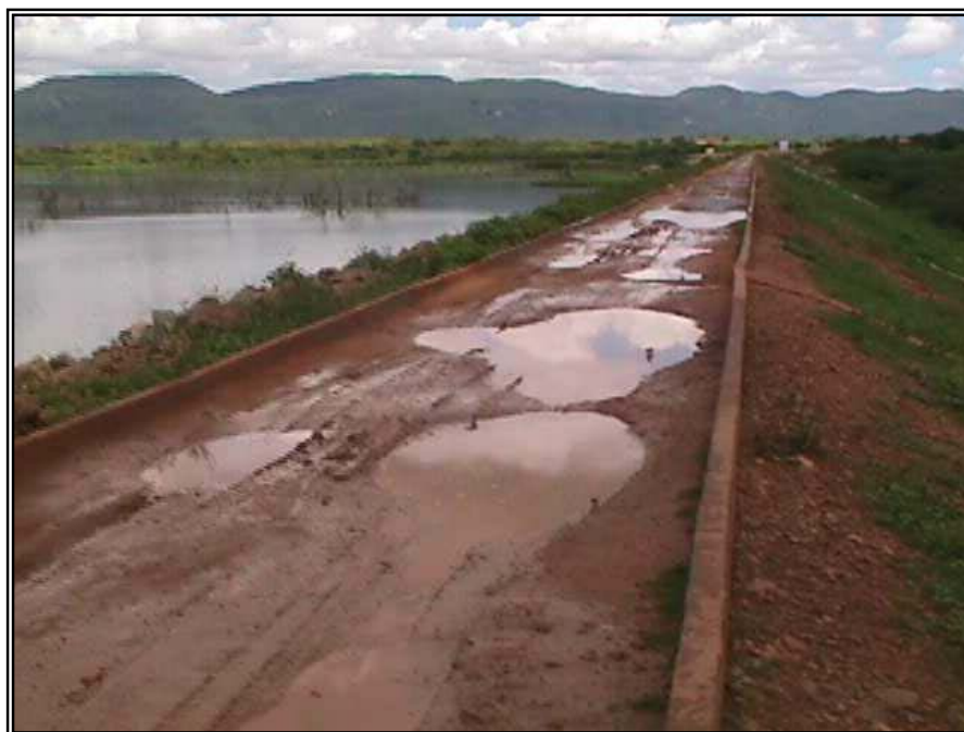
FIGURA 5.8 - Foto com Exemplo de Anomalia de magnitude M (Média)
