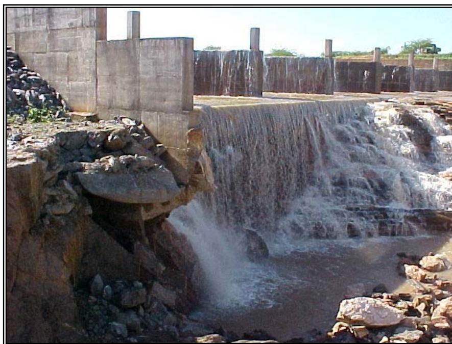
FIGURA 5.9 - Foto com Exemplo de Anomalia de Magnitude G (Grande)
