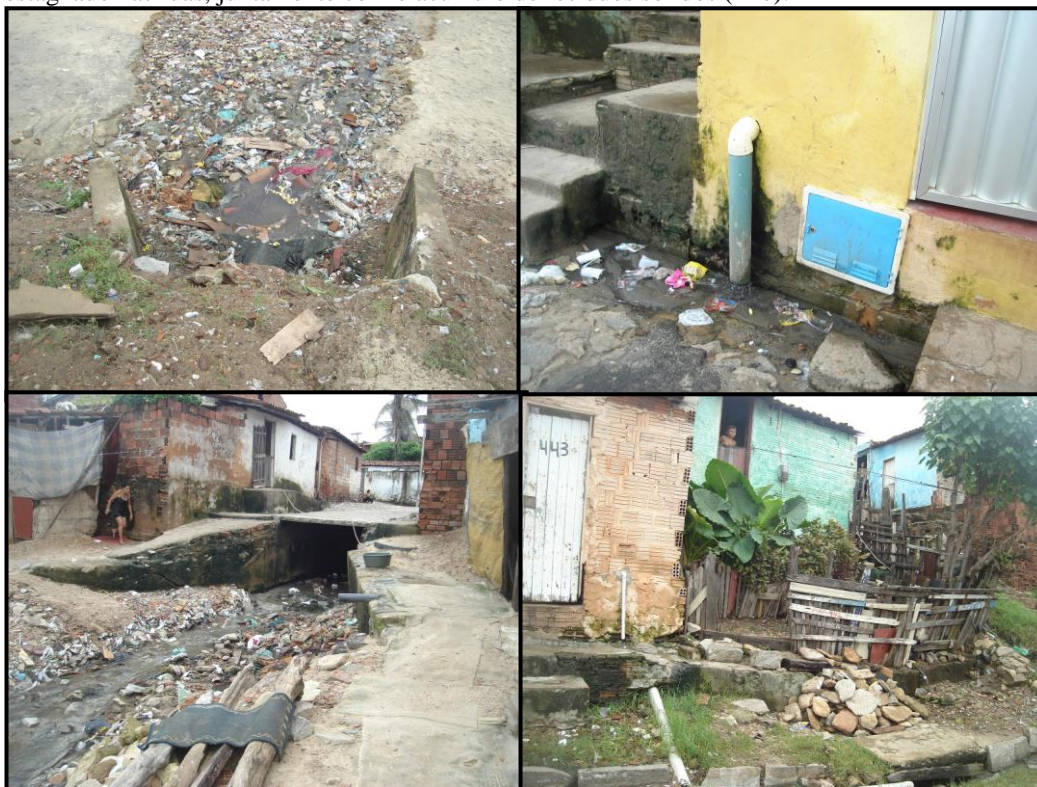
Figura 19 - Exemplos em que o esgoto é lançado inadequadamente no bairro Pirambu, tendo como destino final o mar, vias, passeios públicos, dentre outros locais. O líquido fica estagnado nas ruas, juntamente com o acúmulo de resíduos sólidos (lixo).
