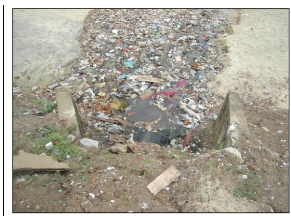
Figura 15 - Esgoto a céu aberto na faixa de praia no bairro Pirambu.
