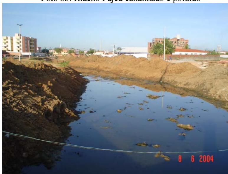
Foto 85: Riacho Pajeú canalizado e poluído
