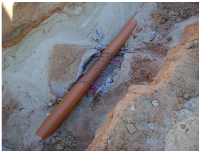
Figura 21 – Interferência encontrada na obra do Porto das Dunas
