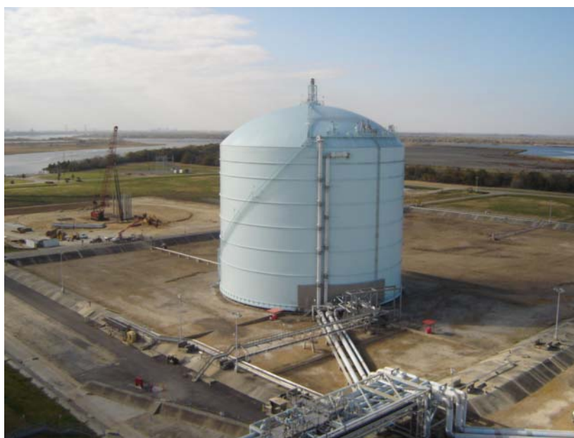
Figura 2.5 – Tanque de Armazenagem de GNL
