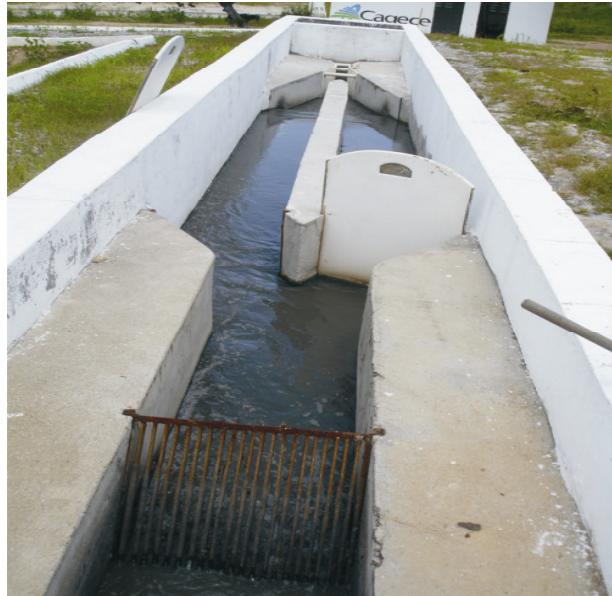
Figura 9 - Caixa de areia para a retirada de resíduos sólidos em Pacatuba-CE – 02/07/2008. Fonte: CAGECE (2008).
