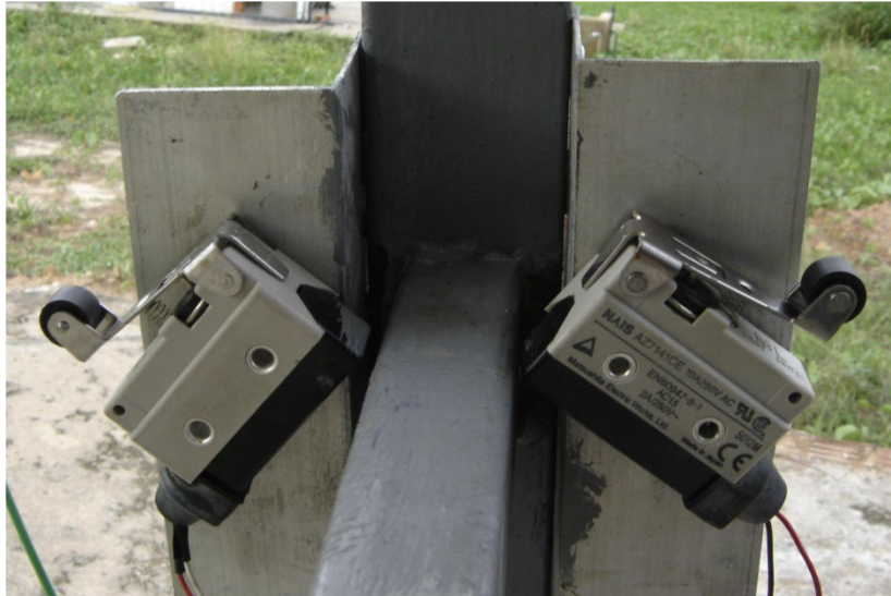
Figura 4.6 - Sensores limitadores de movimento fixados na estrutura do concentrador.
