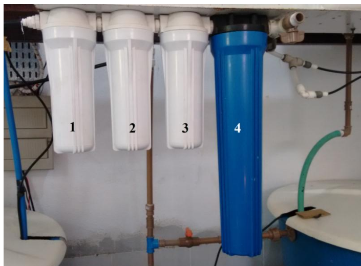
Figura 4. 5 - Elementos de pré-tratamento
