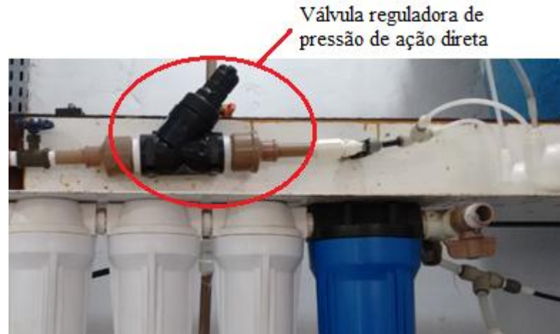
Figura 4. 11 - Válvula de controle de pressão à saída do concentrado
