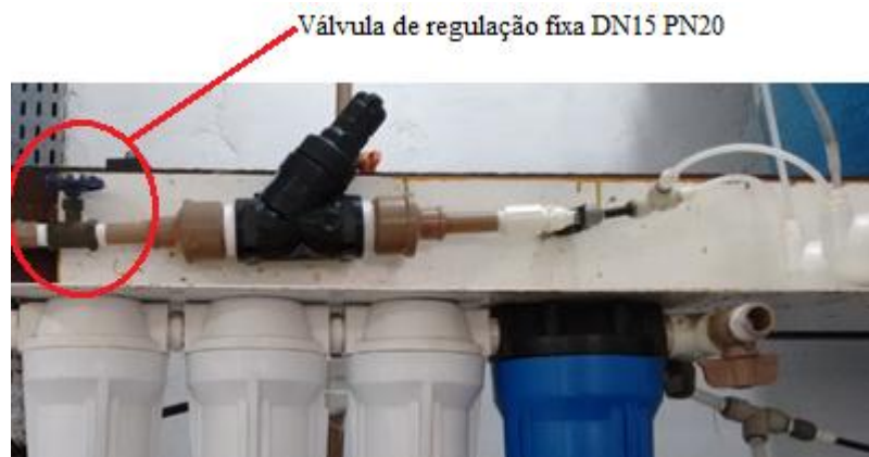
Figura 4. 13 - Válvula DN15 PN20 instalada após a valvula 0075PRV BERMAD
