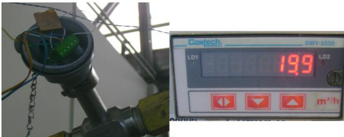
Figura 4.45 – Sensor de Vazão tipo turbina e painel digital
