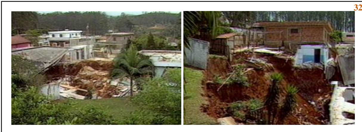
Figura 24 - Fotos de crateras que surgiram em Cajamar (SP) provocadas por dolinamentos de colapso.
