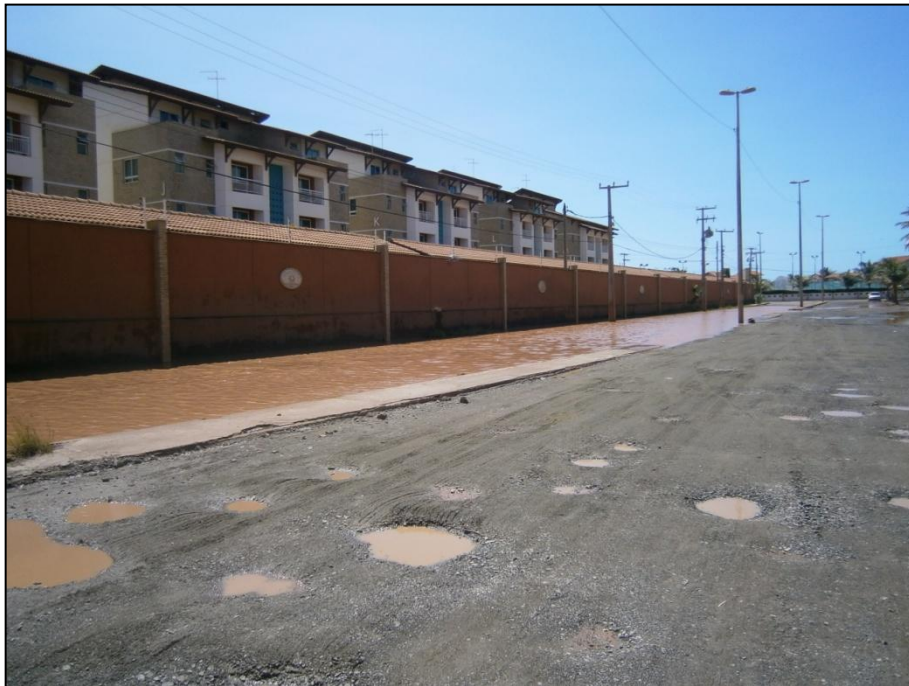
Foto 06 - Avenida Medusa no Porto das Dunas, Aquiraz - CE, parcialmente alagada por falta de sistema de drenagem. Coord.: 9575904/566981 (Janeiro/2014)
