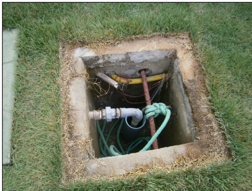
Foto 13 - Poço tubular (em uso) sem proteção sanitária, localizado na Av. Cajueiro, s/n, Porto das Dunas, Aquiraz - CE. Coord.: 9575266/567127 (Janeiro/2014)
