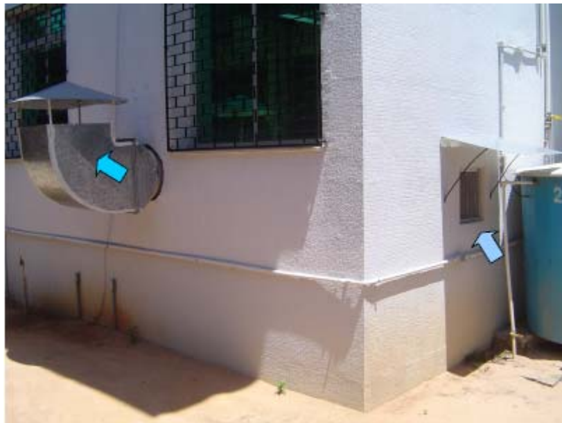
Figura 4.8 – Ventilador centrífugo. Exterior do laboratório.
