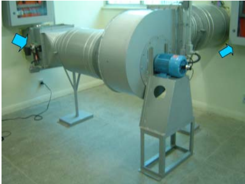
Figura 4.7 – Ventilador centrífugo. Interior do laboratório.
