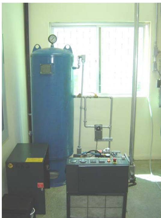
Figura. 4.15 – Compressor junto com o reservatório de ar.
