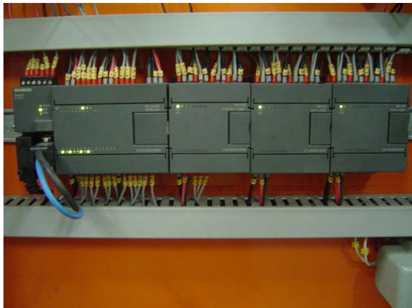
Figura 4.4 – Hack do CLP dos ventiladores
