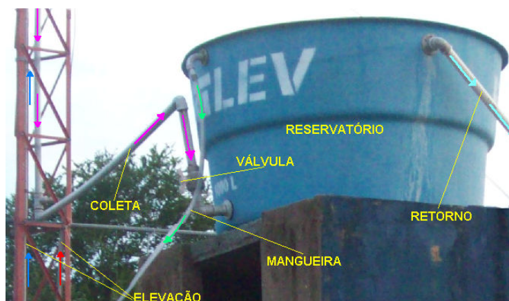
Figura 3.20 Reservatório e parte da tubulação externa
