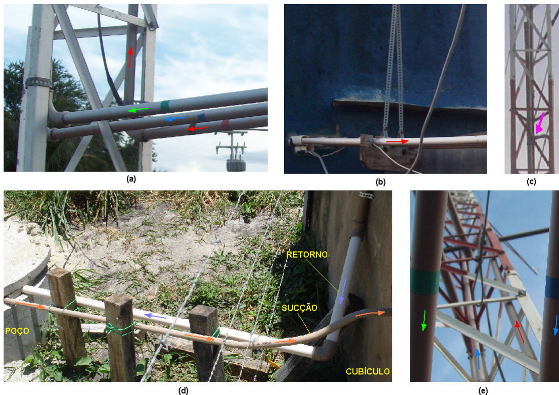
Figura 3.18 Detalhes da tubulação exterior ao cubículo
