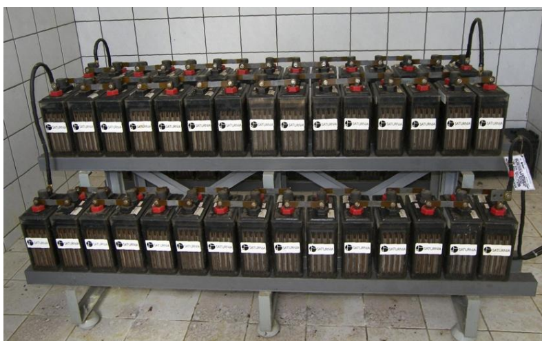
Figura 2.7 - Banco de Baterias.
