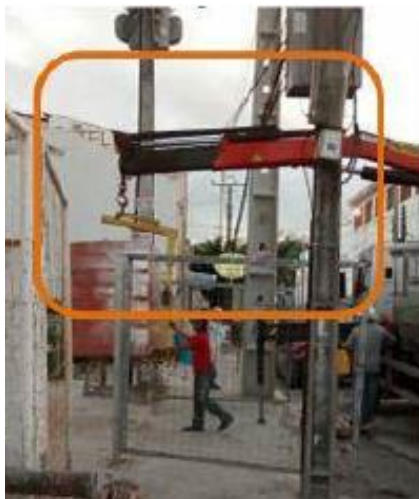
Figura 20 - Caminhão descarregando próximo a fiação
