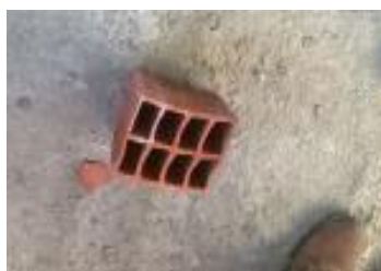
Figura 27 - Tijolo não conforme
