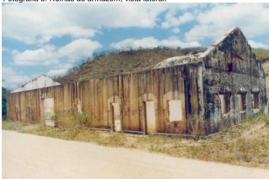
Fotografia 5: Ruínas do armazém, vista lateral.
