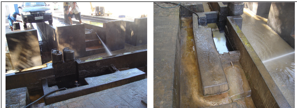
Foto 7.2 – Separador de água/óleo utilizado em posto de combustível com área de lavagem de carros. 464027W / 9201612S. (03/05/2007).
