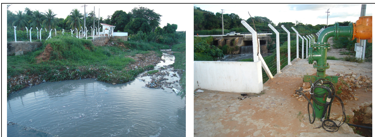
Foto 7.8 – Poço PT-03 da CAGECE na margem esquerda do rio dos Macacos poluído com esgoto doméstico. 466512W / 9201622S. (03/05/2007).
