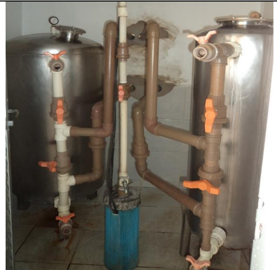
Figura 4: Conjunto de filtros na saída do poço. Fonte: Costa, 2012
